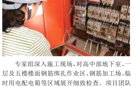
专家组深入施工现场,对高中部地下室、一层及五楼楼面钢筋绑扎作业区、钢筋加工场、临时用电配电箱等区域开展细致检查。项目团队
